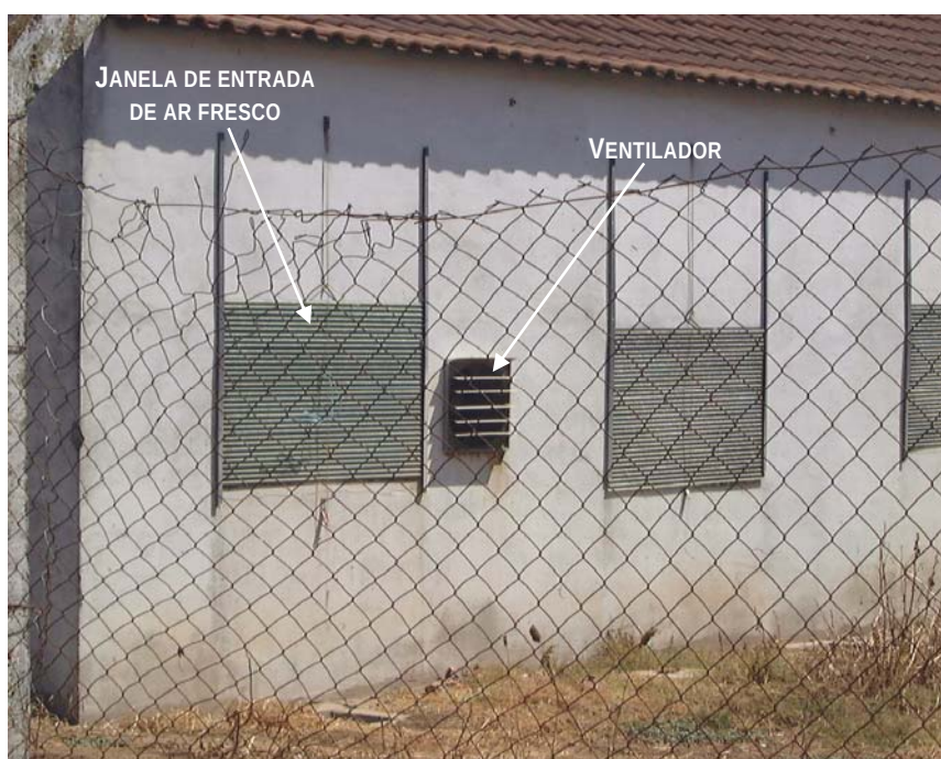
Figura.10 - Sistema de ventilação dos pavilhões.
